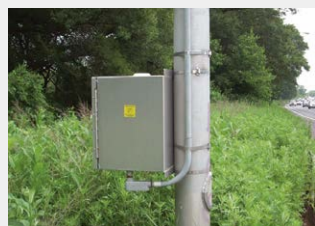
Cajas para Utilerías
